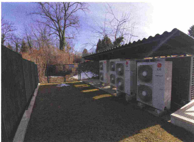
Le unità esterne Therma V installate in una collocazione dedicata e protetta
