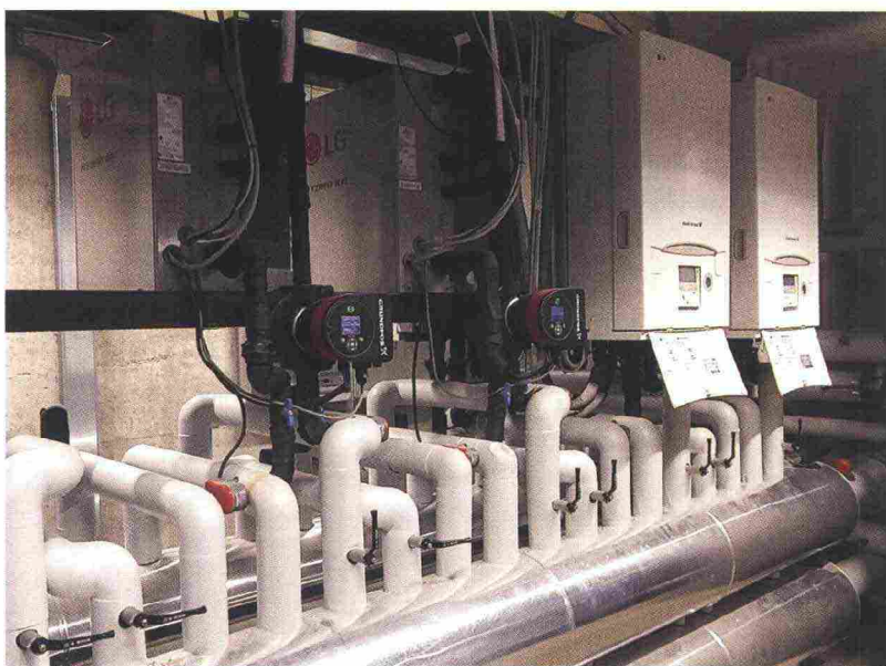
La "sala macchine" di distribuzione al sistema radiante
